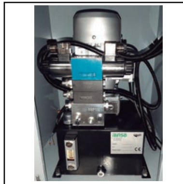
Grupo hidráulico en el interior del banco armario con visor de control.
