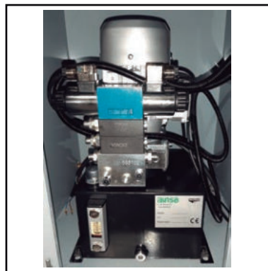
Grupo hidráulico en el interior del banco armario con visor de control.
